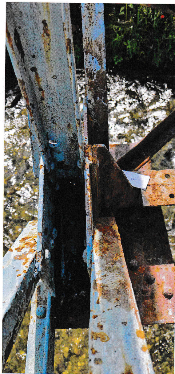
Zdj 13: Widoczna korozja węzła
