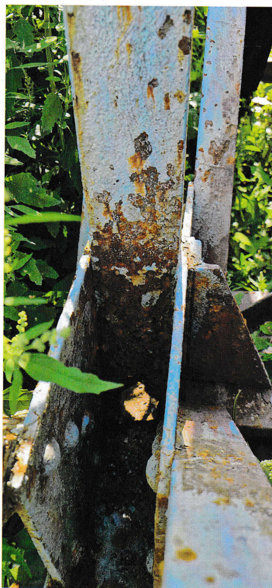
Zdj 8: Widok uszkodzenia węzła
