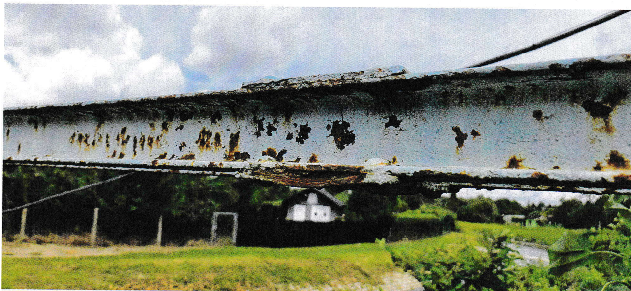
Zdj 50: przewiązka zdeformowana przez dużą objętość produktów korozji między nią a pasem (do wymiany)
