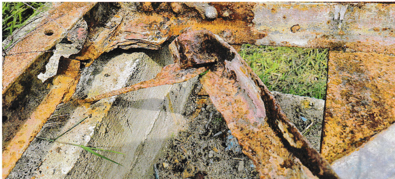
Zdj 52: Węzeł podporowy - widoczny brak ciągłości dolnego pasa i środnika poprzecznicy, "łuszczenie się" grubej blachy podstawy, zdeformowany pręt stężenia, odspojona blacha węzłowa (elementy węzła do wymiany)
