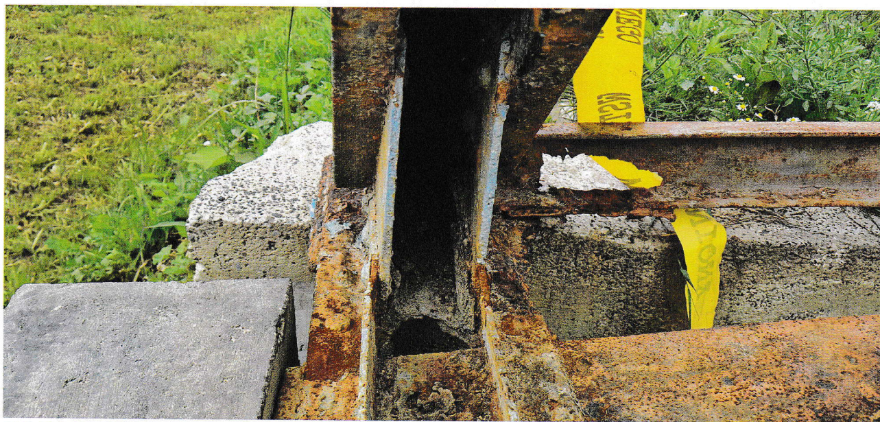
Zdj 57: Jw. Widoczny ubytek naroża fundamentu, ciemne kruszywo w betonie, zaawansowana korozja konstrukcji stalowej
