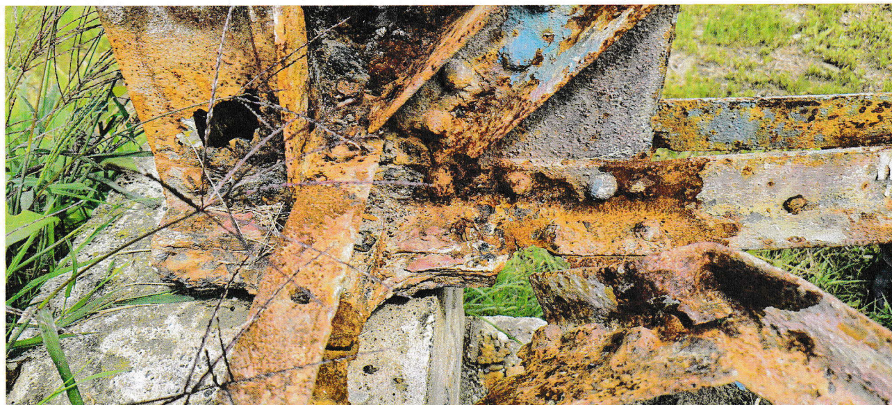
Zdj 53: jw oraz znaczny ubytek pionowej blachy węzłowej
