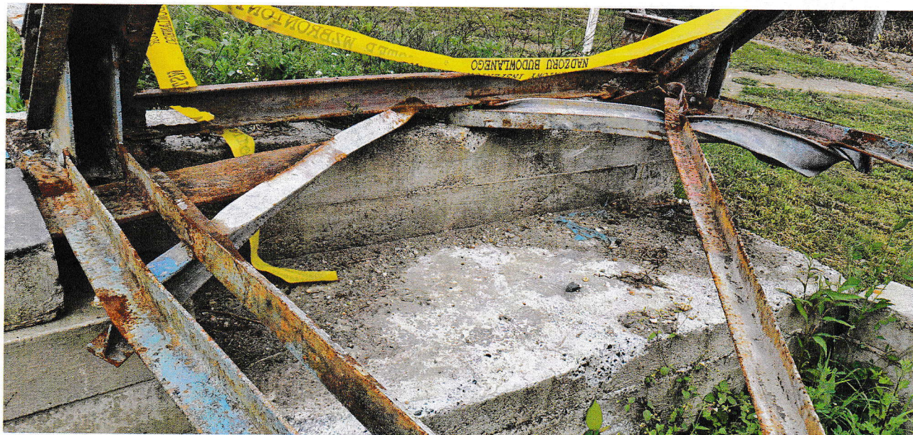
Zdj 56: Zniszczone wzmocnienia i luźne bloczki przy jednej z podpór
