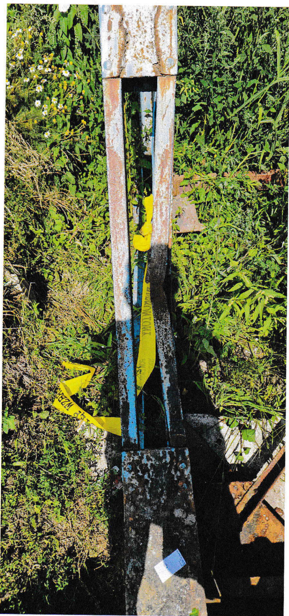
Zdj 44: Widoczne deformacje dwugązłowego krzyżulca przy jednej z podpór (do prostowania lub wymiany)
