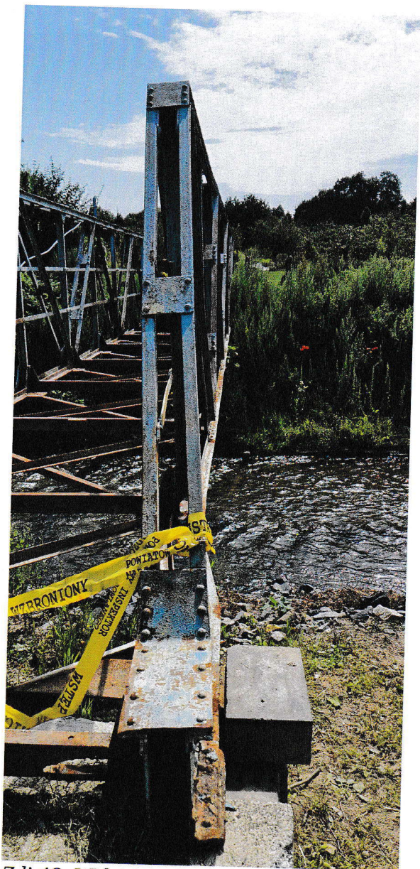
Zdj 46: Widoczne wygięcie całego obiektu z płaszczyzny kratownicy (możliwe do zniwelowania pod warunkiem wymiany elementów pasa dolnego i węzła podporowego)
